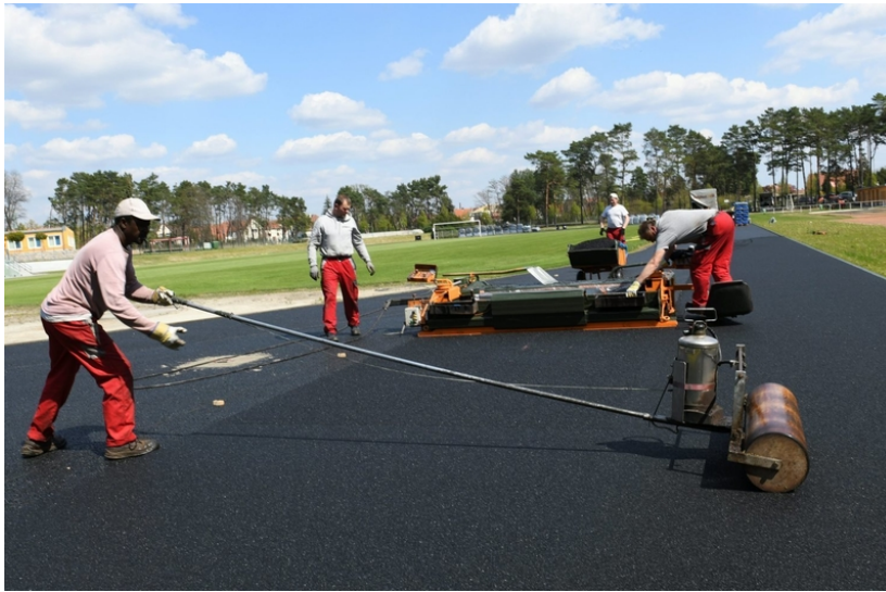
Am Stadion der Kraftwerker in Weißwasser wird derzeit die Rundbahn fertiggestellt. Joachim Rehle
